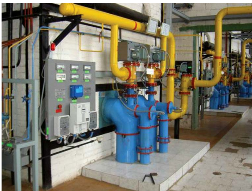
Рис. 1. Тепловая станция НГДУ «Джалильнефть»
